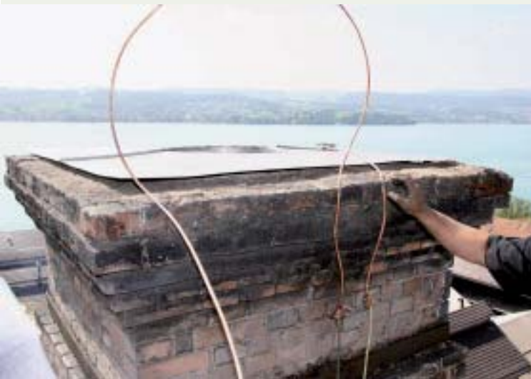
Zum Schluss wird auf 36 Meter Höhe der Blitzschutz dem neuen Kamin angepasst.
